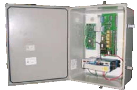
Estación operadora de control
